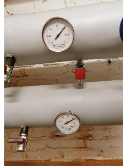
← Hohe Rücklauftemperaturen über die Warmwasserspeicher für Kindergarten (Begehung am 06.08.2020)
