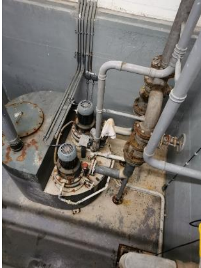
← getaktete Hebepumpen mit taktenden Pumpen
