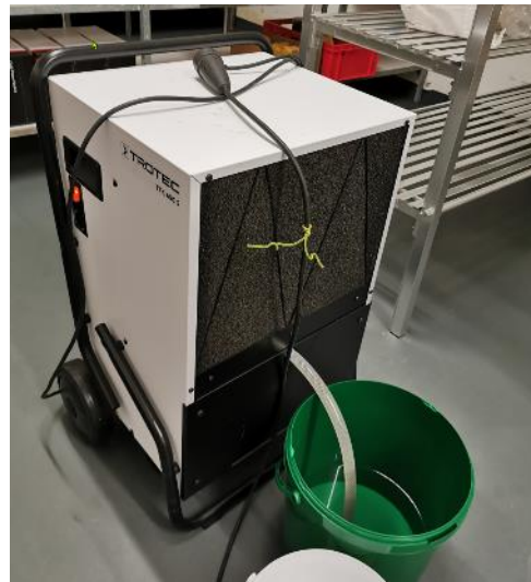
← Luftentfeuchter der im Kreis entfeuchtet
