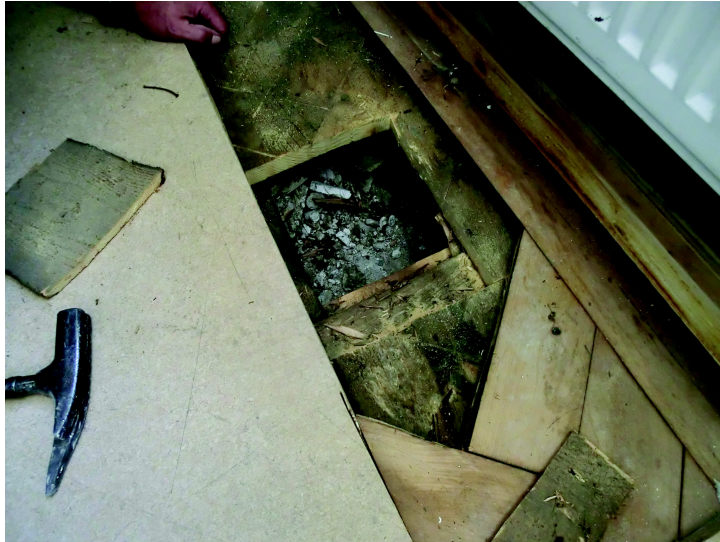
OG- an Außenwand, Gebäudeecke SO/SW
