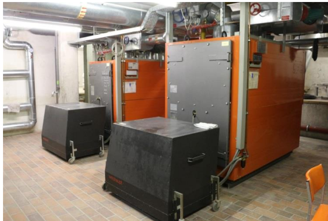
Kesselanlage mit Brenner
