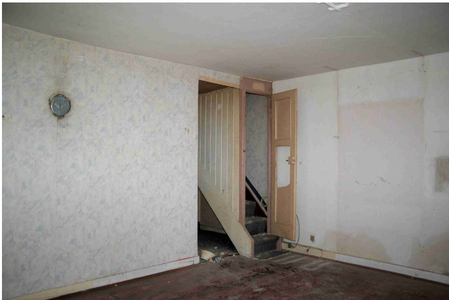
Abb. 9 Erdgeschoß, südlicher Raum (Stube). Blick inach Nordosten mit dem Treppenaufgang zum Obergeschoß. Links unter der Tapete in Backstein gemauerte starke Feuerungswand für einen Stubenofen.
