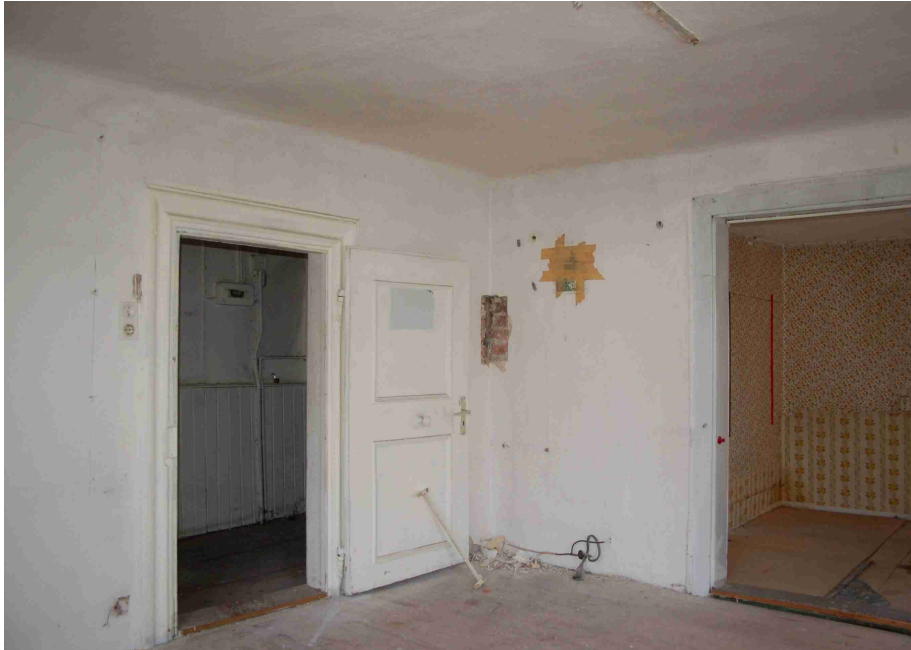
Abb. 21 2. Obergeschoß, nordwestlicher Eckraum (Stube). Blick nach Südosten. Links die Ostwand mit barockem Türrahmen und barockem Füllungstürblatt.
