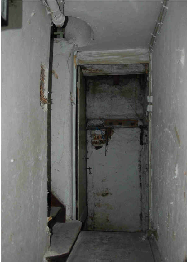
Abb. 12 Erdgeschoß, Blick durch den Treppenflur nach Osten auf den Kellerabgang. Nordwand (links) und Südwand (rechts) sind überputzte Fachwerkwände aus dem 19. Jahrhundert.
