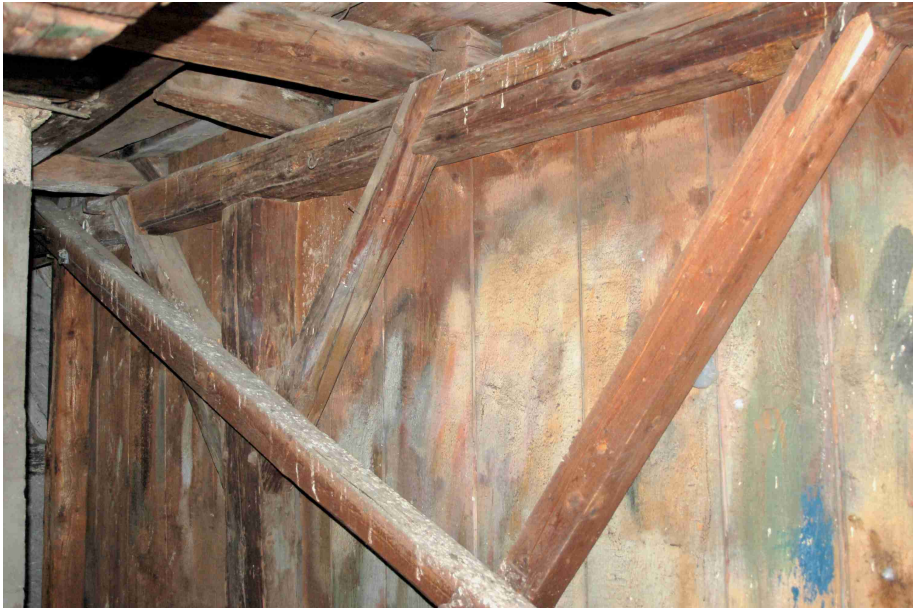
Abb. 31 1. Dachgeschoß, Mittelbereich. Südlicher stehender Stuhl, der im späten 16. oder frühen 17. Jahrhundert nachträglich unter das Kehlgebälk des 16. Jahrhunderts gestellt wurde.
