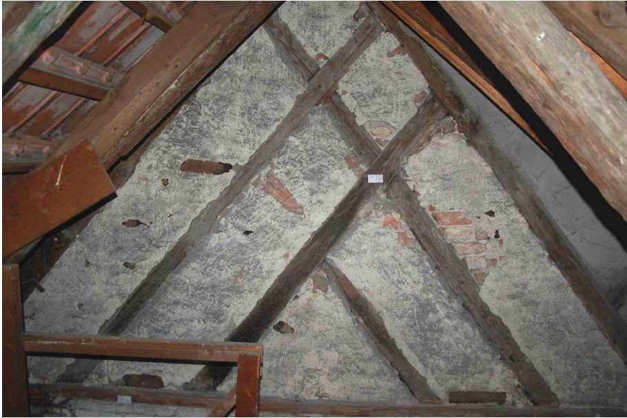
Abb. 33 2. Dachgeschoß. Blick gegen die östliche Giebelscheibe mit doppelter Auskreuzung wohl des 16. Jahrhunderts.
